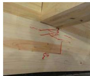
No1下側CLTの曲げ破壊
