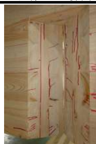
上側CLT接合部の割れ
