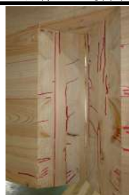
上側CLT接合部の割れ
