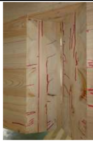
上側CLT接合部の割れ
