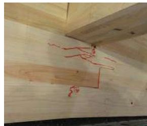
No1下側CLTの曲げ破壊
