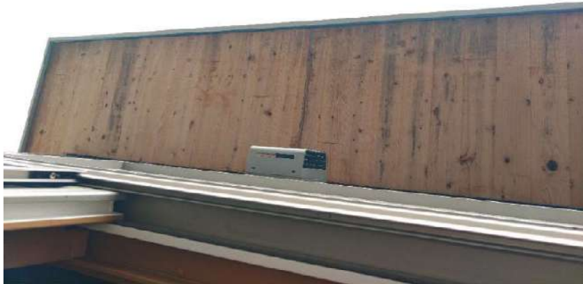
南側(正面玄関側)軒天部 屋根パネル間の隙間にはコーキング処理を施したので、雨漏りは見られなくなった。
