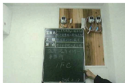
カバヤホーム倉敷北店展示場：設置状況(室内)
