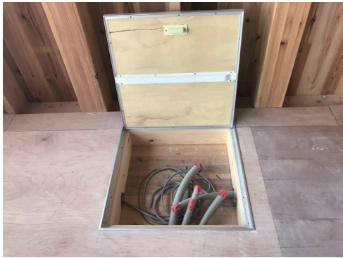
乾式二重床を利用した電気配線
