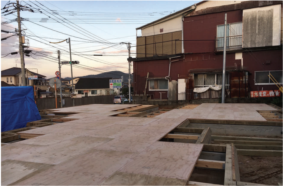
写真 2 CLT が乗る土台周辺を残し、床組の上に床下地の合板を先に貼り、作業用のプラットフォームを作った。土台の際には CLT パネルの引っかかりとなる帯状の合板を接着剤とビスの併用で固定
