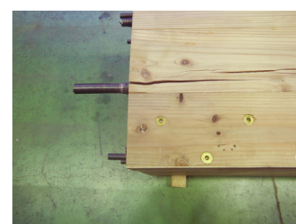
GIR 接合部分での割れ
