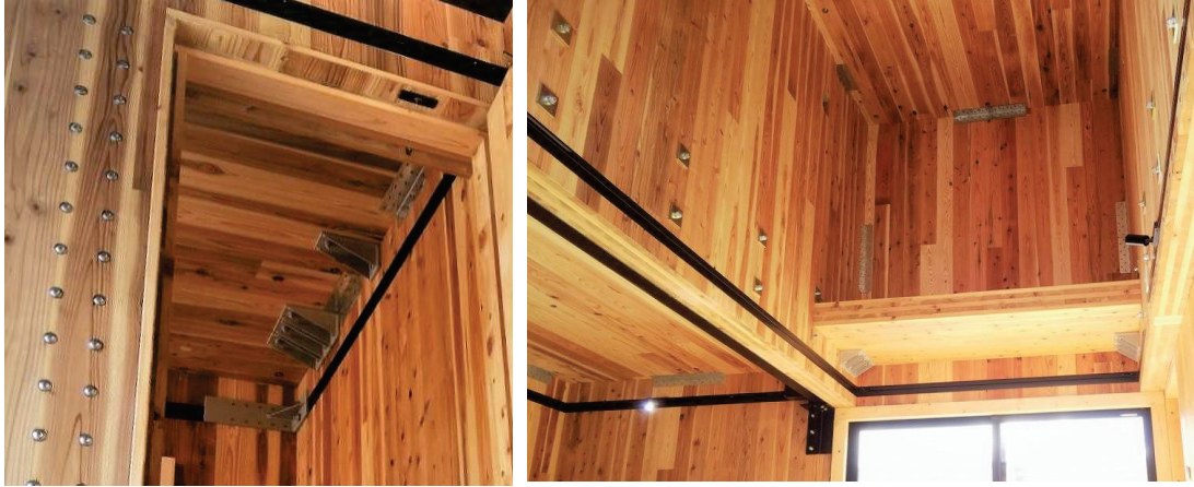
写真 2.3-1 構造用金物（左：エントランスと休憩室 2、右：休憩室 1）
