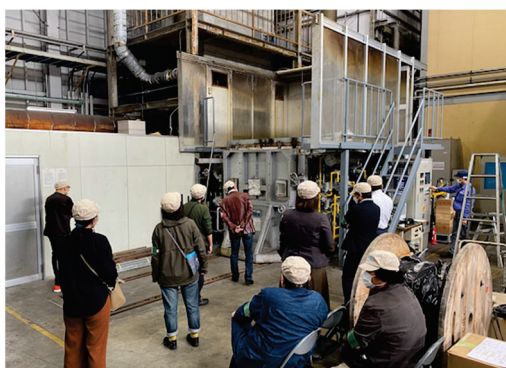
写真4.2.1 加熱炉全景(加熱中の様子)
