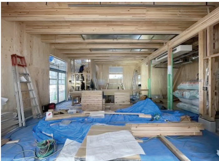
○作業場1、作業場2(1階) CLTの折版屋根の天井を綺麗に見せるため、2階事務室の空調は床吹き出しとしている。1階作業場2の天井に空調機を設置し、2階の床を構成する梁の間にダクティングをしている。
