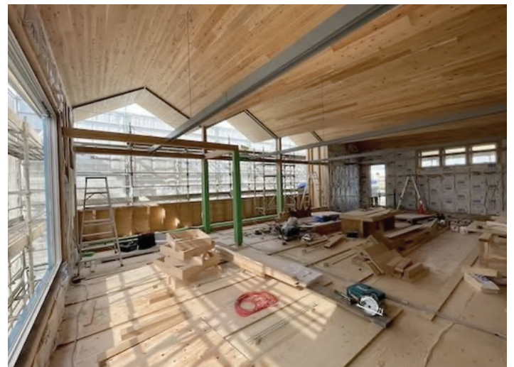
○事務室(2階) H鋼は照明ボックスの上下にLED照明を設置。天井を照らす間接光はまちの街灯の役割を果たす。
