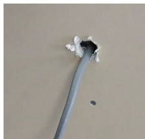
天井配線部の穴
