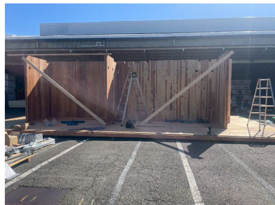
図4 足元の開きを抑制する仮筋交い
