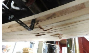
写真 3-4-12 下面繊維の破断
